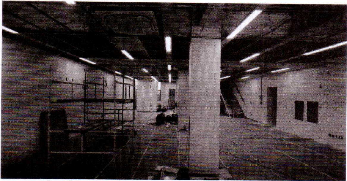
Revestimento novo forrado em papelão, a fim de evitar possíveis danos.
